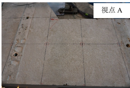
写真-4.2 側壁ハンチ下部ひび割れ発生時
