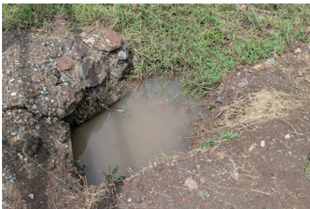
▲ 蚊の卵を確認した排水不良箇所
