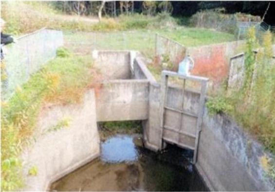
写真5. 不動池配水施設
