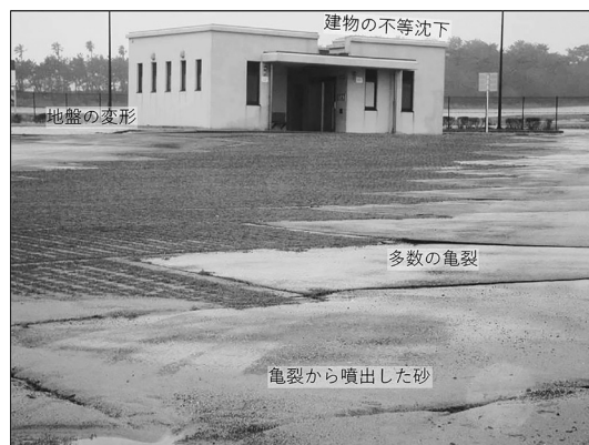
写真 3-4 海の中道海浜公園の被災状況
