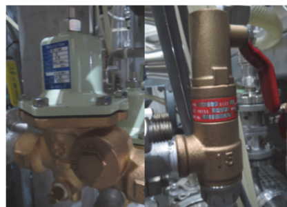
図 4 交換後の減圧弁(左)・安全弁(右)
