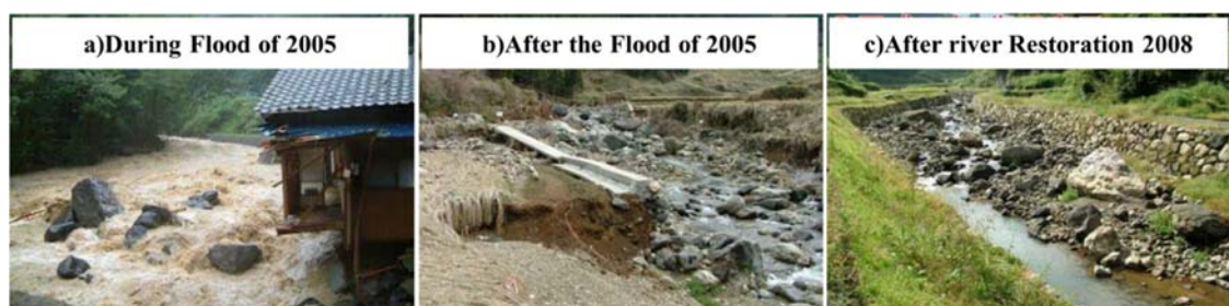
図 5.2.2 a 研究対象河川の洪水時の様子(2005), b 被災直後の河川の状況(2005), c 改修直後の河川の状況(2009)
