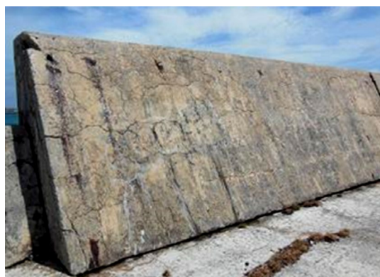
(a) 無拘束の場合 (亀甲状のひび割れとなる)
