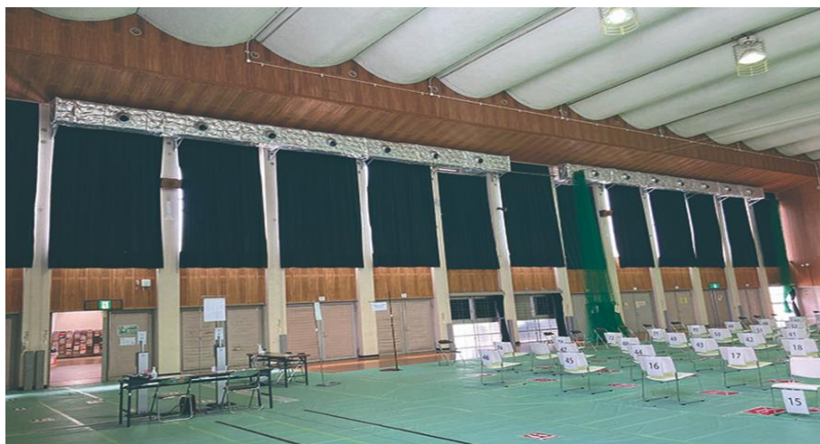
図 2.17 体育館に 1 列に並んだ給気口 [6]
