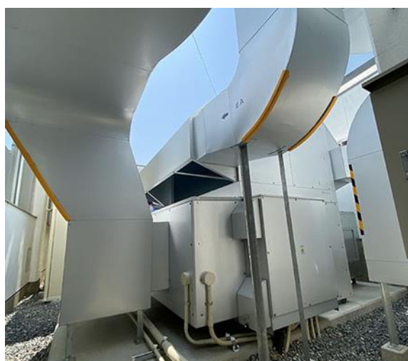
図 2.1 外気処理空調機 [6]
