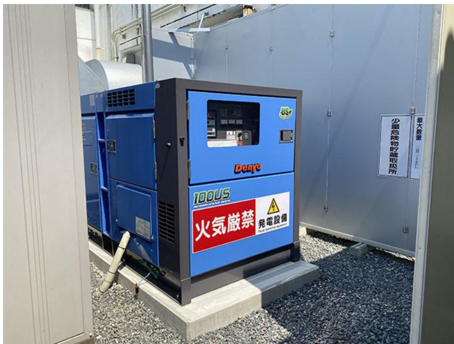
図 2.8 電源供給の発電機 [6]
