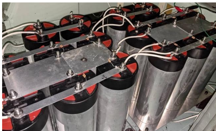
図 2.7 キャパシターバンクの外観
