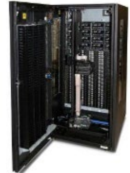
サーバ計算機 ×11台
