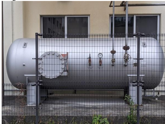
Fig. 3.2 高圧ガスタンク
