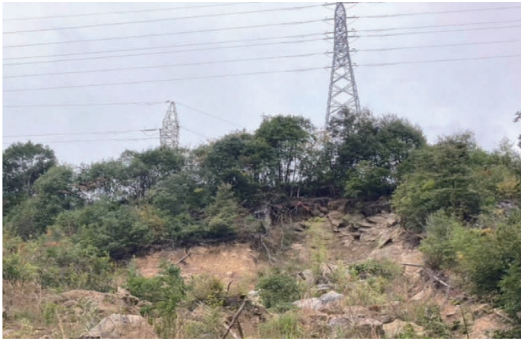
図 11 崖崩れとメガソーラーの鉄塔 出典：第 1 著者撮影
