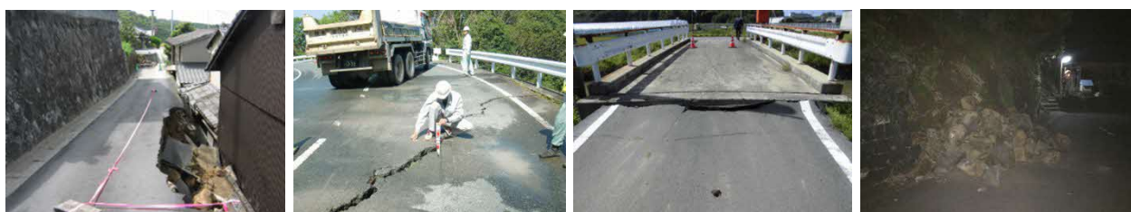
図－1.1.1 玉名市における熊本地震による市道の被災状況
