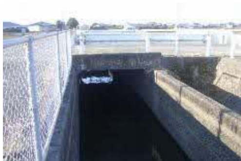
図－2.10 管理区分が不明確な橋梁
