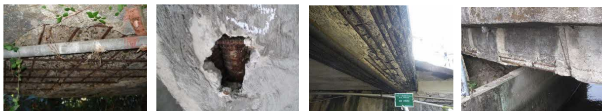
図－3.2 本市の市道橋の損傷状況
