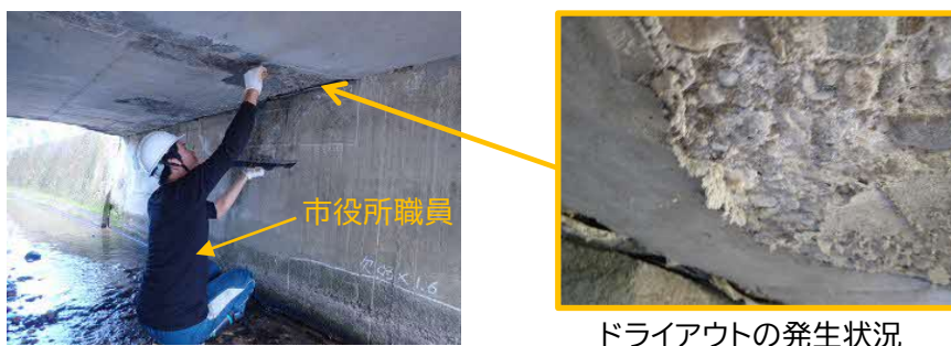
図-3.19 豆板部の断面修復で生じたドライアウト事例（直営施工）
