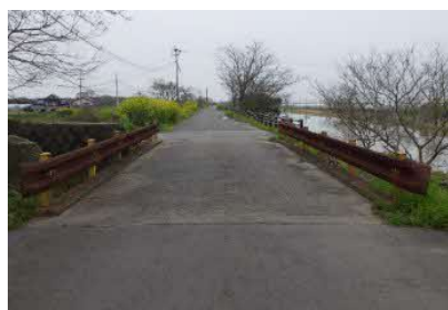
(a) 腐食したガードレールの状況
