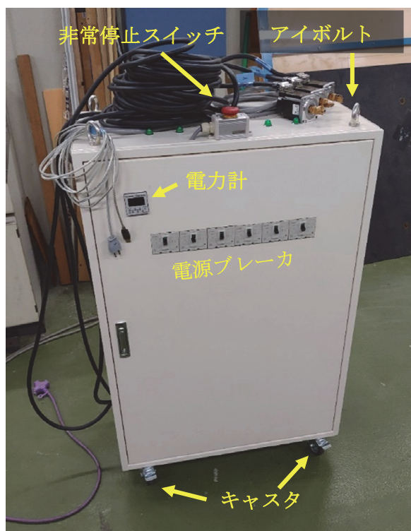
図4 制御盤の外観
