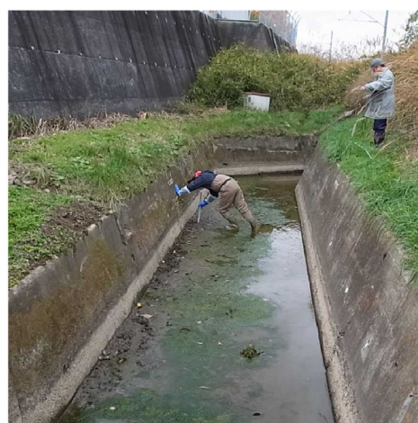
(b) 地点 D 支線水路の堆積状況
