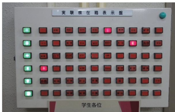
図1 押しボタンによる切替盤
