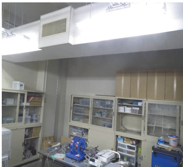
図 2 照明の光が遮られた箇所
