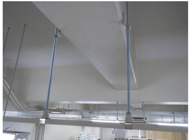
図6 天井の梁に固定したハンガー
