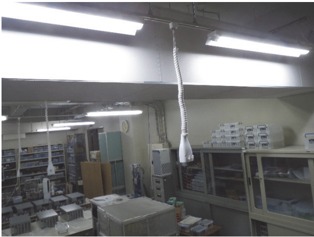
図5 新設したLED照明
