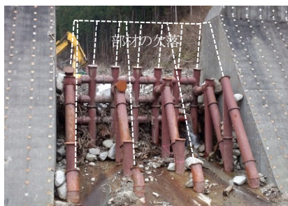
(a) 全景 (部材の欠落)
