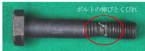
写真-10 接合ボルトの損傷状況の一例
