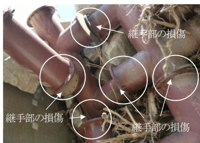
(b) 近景 (継手部の損傷)
