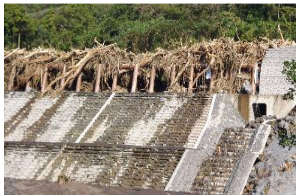
写真-1 伊豆大島の土砂災害
