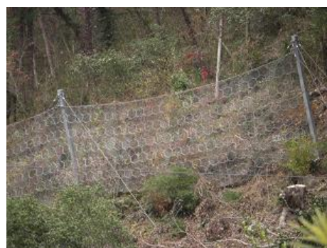
写真-1 ワイヤリング落石防護柵
