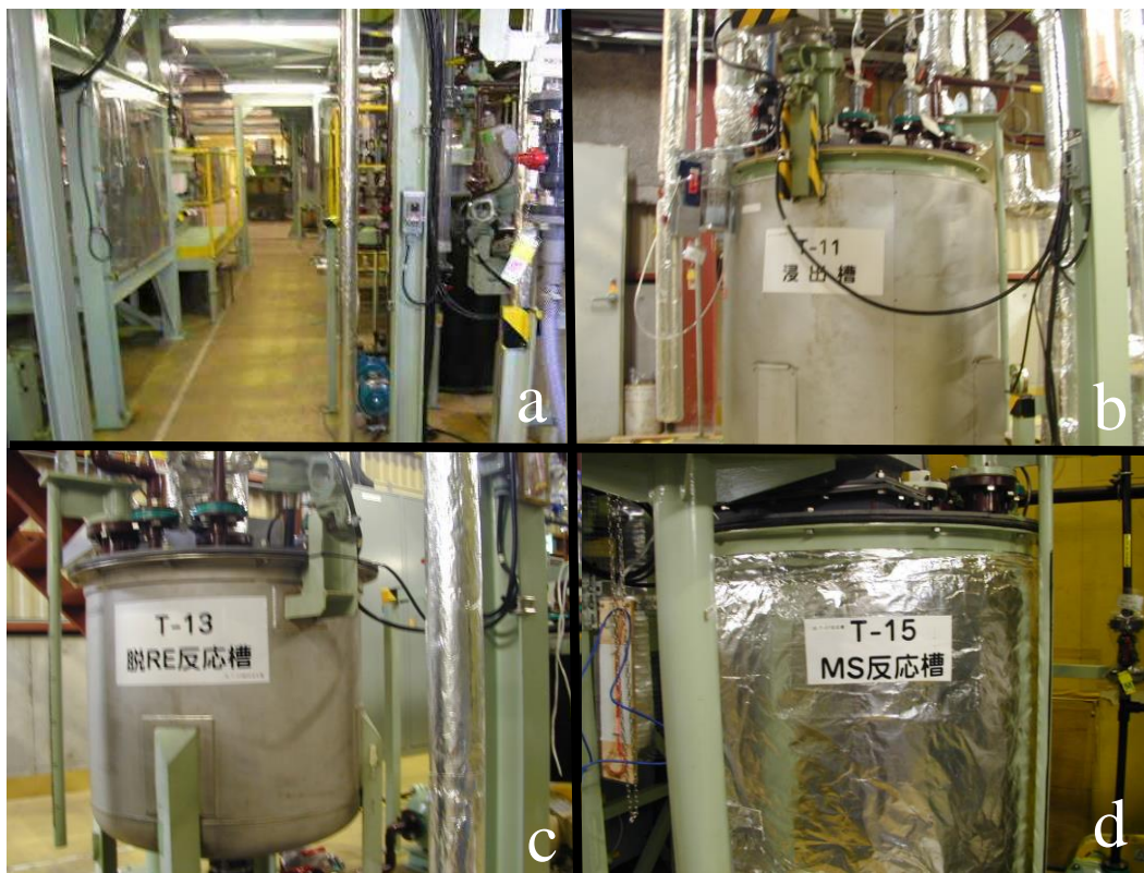
Figure 3-2. パイロット試験設備の写真
