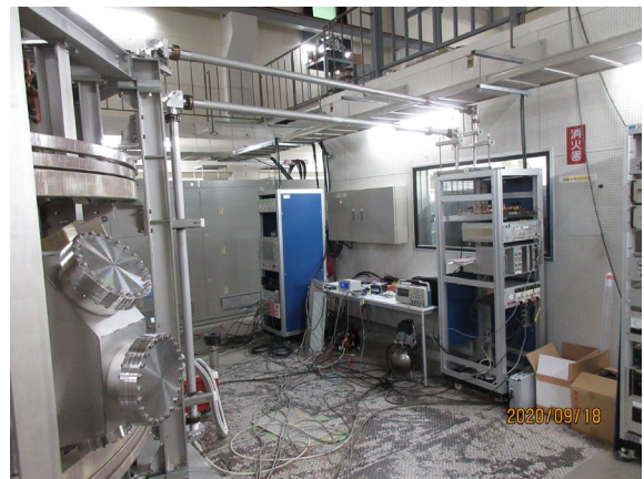
図 2：コルゲート導波管伝送路と計測ラック
