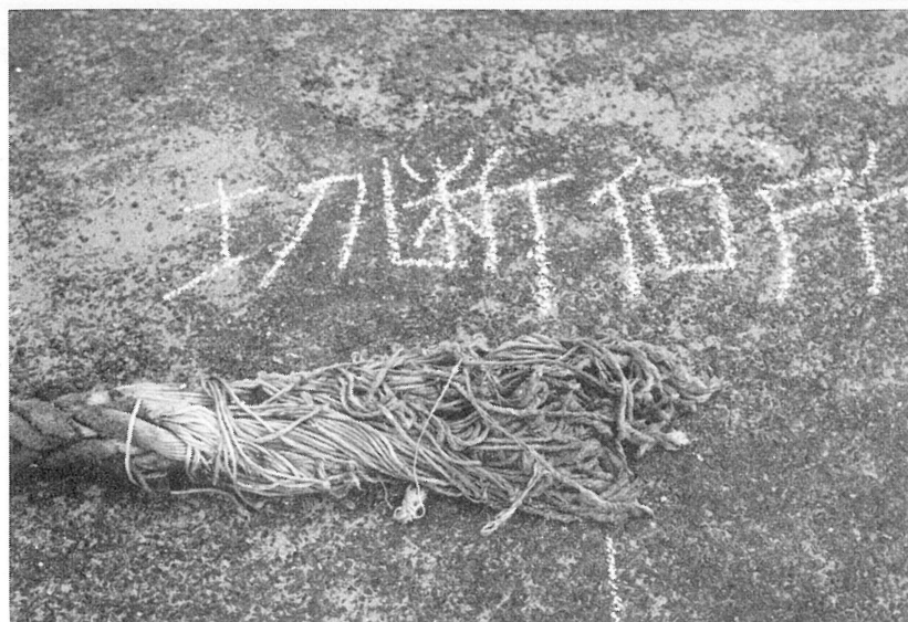
写真 5.6.2 (b) ナイロンロープ切断箇所
