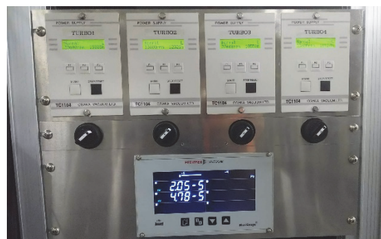
図5 真空機器用制御パネル
