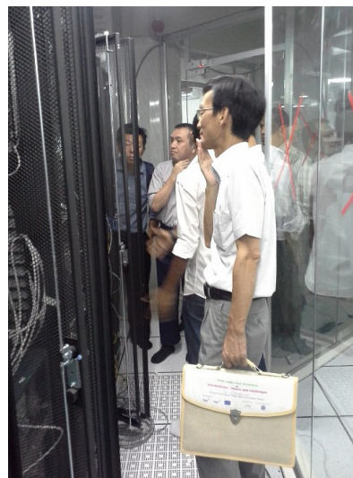
BdREN データセンター
