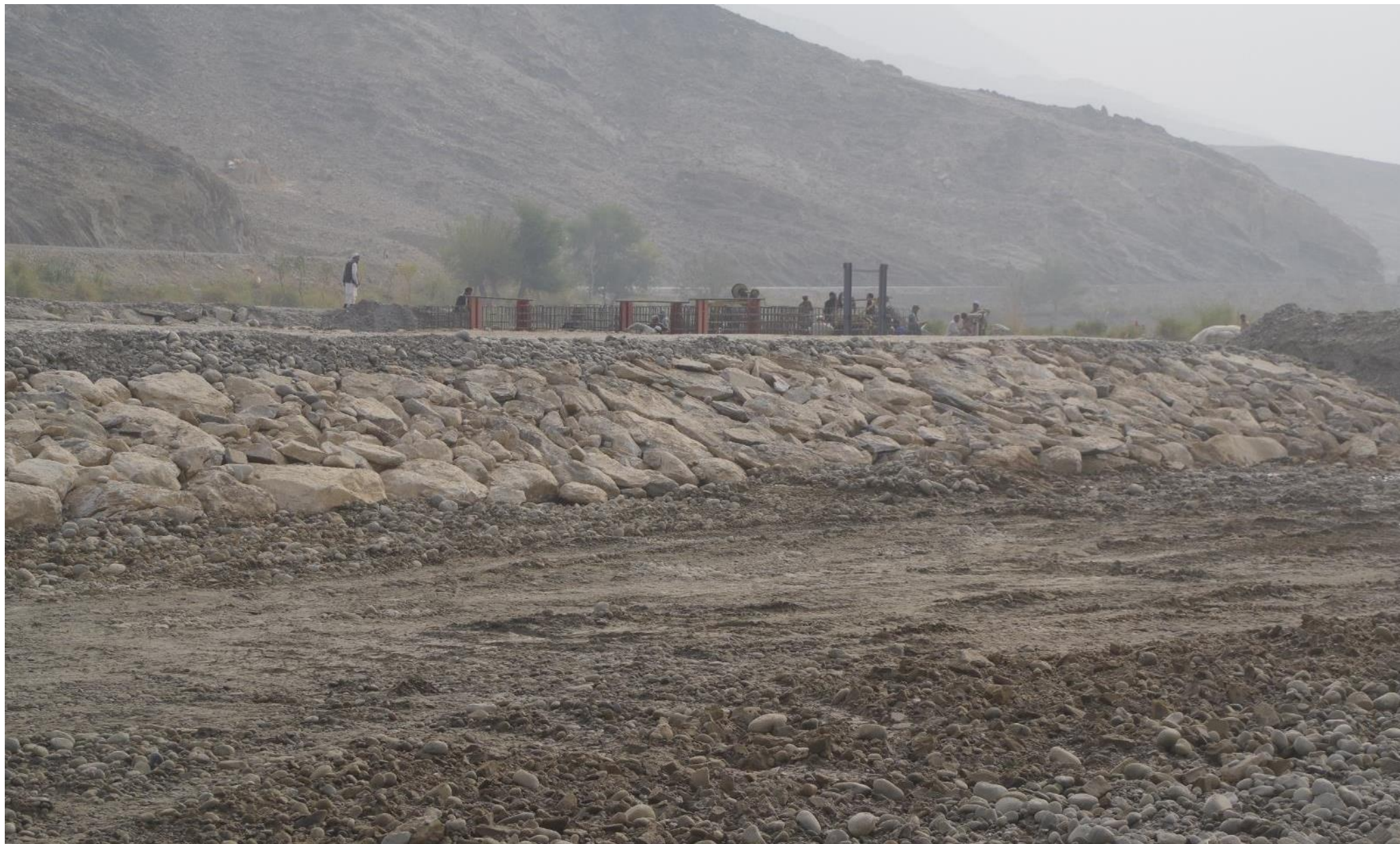
調節池Ⅲの外壁基礎。洪水浸入時に備え、堤防（二重堤防の内側；以前の洪水対策地図参照）を兼ねる。2017 年 11 月 14 日
