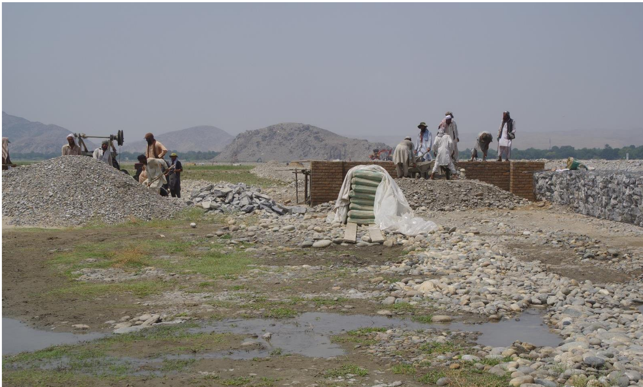
1000m 地点のカチャラ II 分水路始点の工事。コンクリート工事を終え、分水路造成（約 450m）が始まる。2017 年 7 月 22 日
