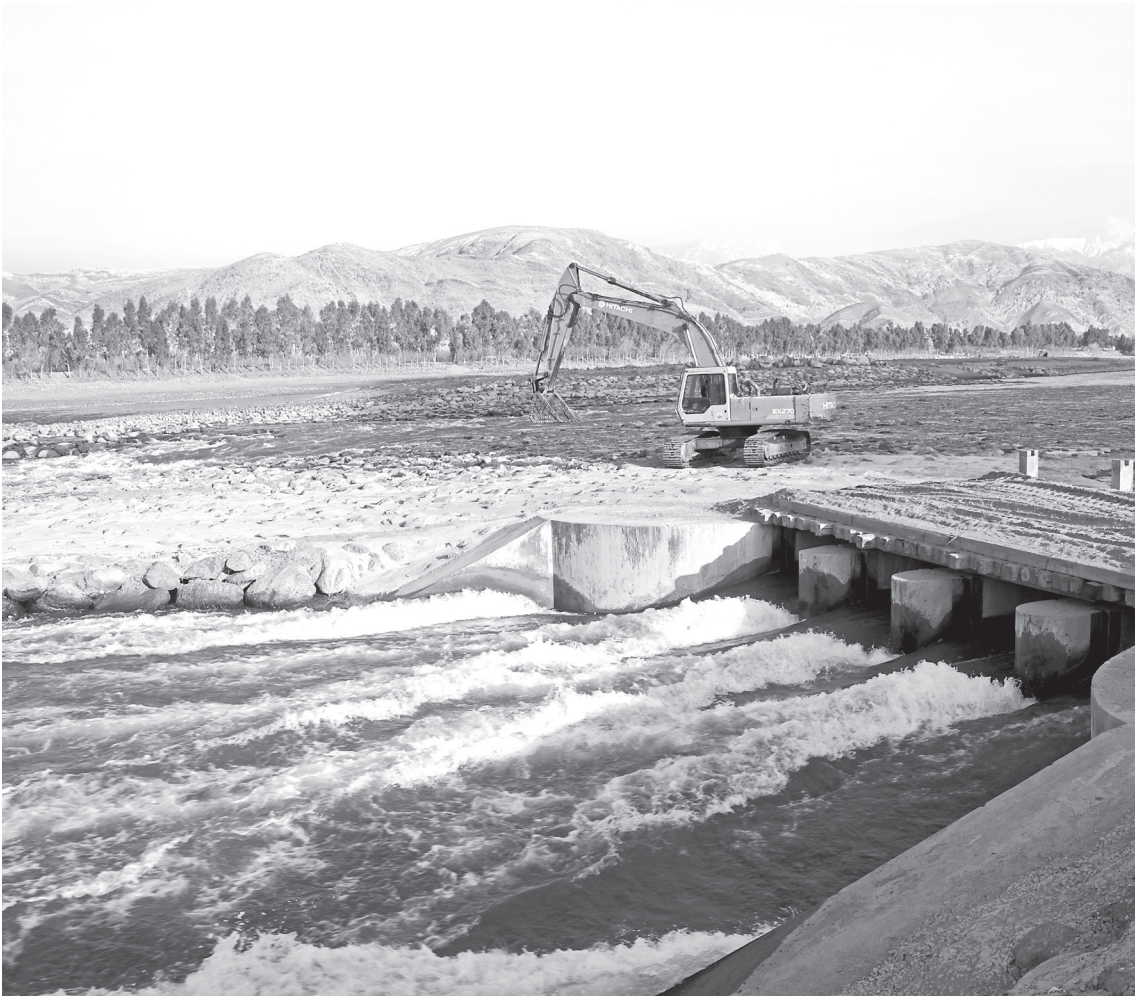
カマ第一堰土砂吐き(2019年1月24日)。取水門前に土砂が堆積しないように、大量に土砂を含む底水を急流で流すと共にクナル河の水位が異常に低い時は、堰板を入れ取水量を確保する。
