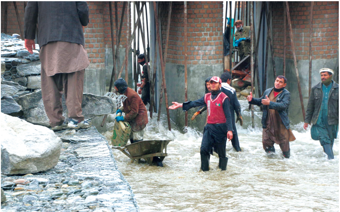
昨年10月に着工したマルワリードII堰の仮工事を終え、1月28日試験送水が行われた。「神、われらと共にあり」と、あちこちから声があがった(2017年1月28日)
