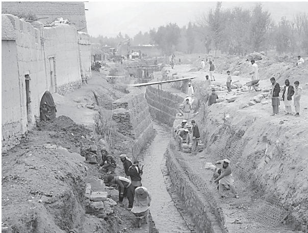
着工からまる1年を経過したガンペリ主幹排水路工事(今夏までに完成する予定)
