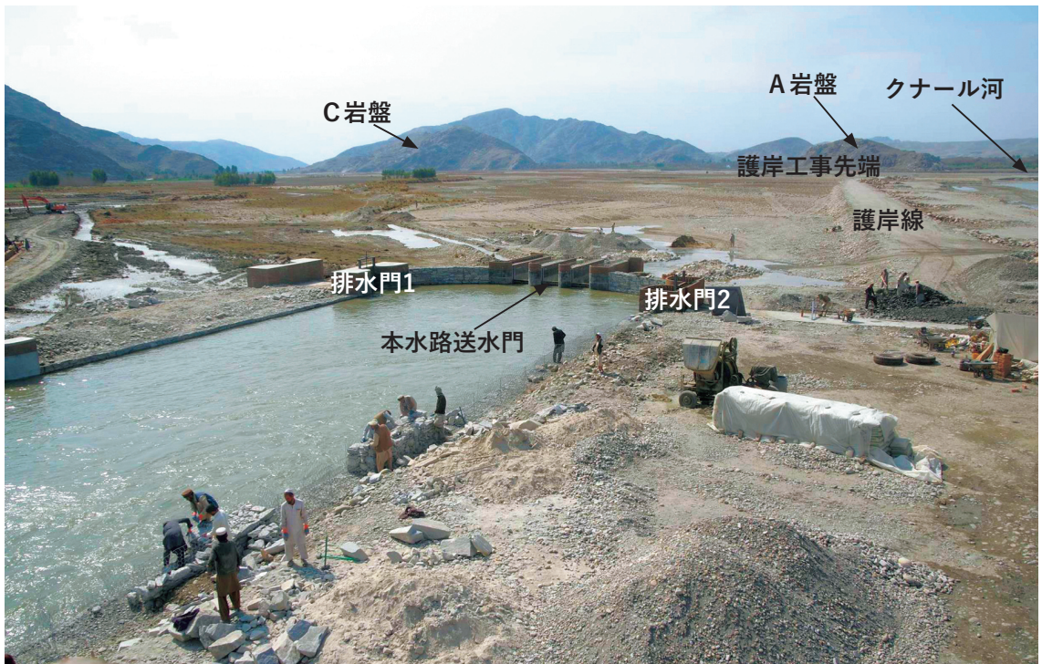
水を湛えた沈砂池。護岸線に沿って造られた石出し水制群が見える。夏の洪水に備えて護岸工事に尽力中(2017年3月7日)
