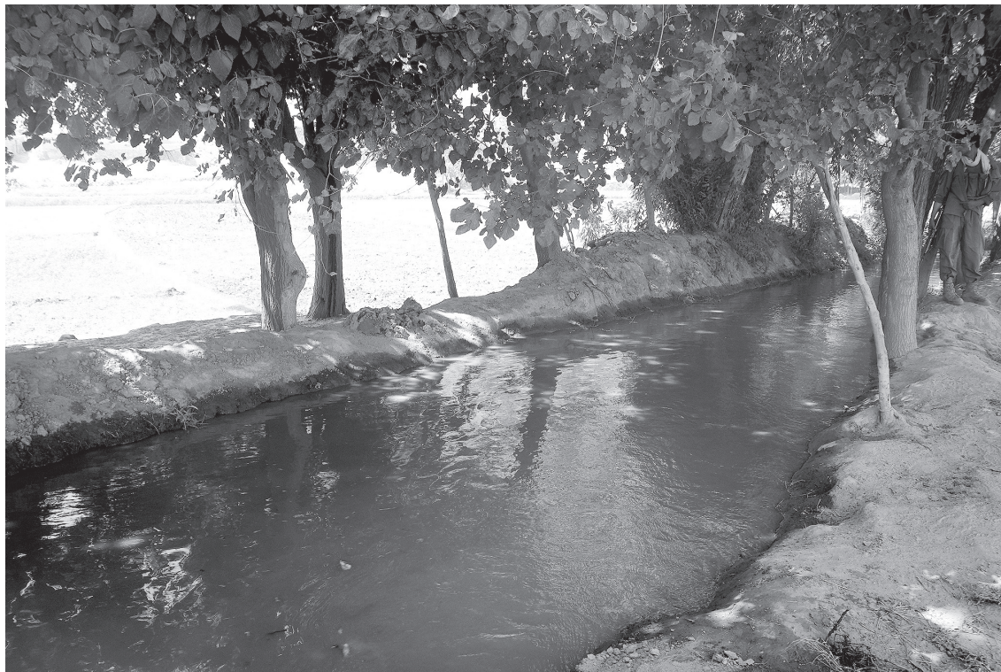
カシコト既存水路。堰からの取水可能量に対して既存水路の容量は半分以下。外壁の傾斜が急で幅も狭いので拡張工事により容量が増大し、飛躍的に農業生産は上がる（2013年7月8日）
