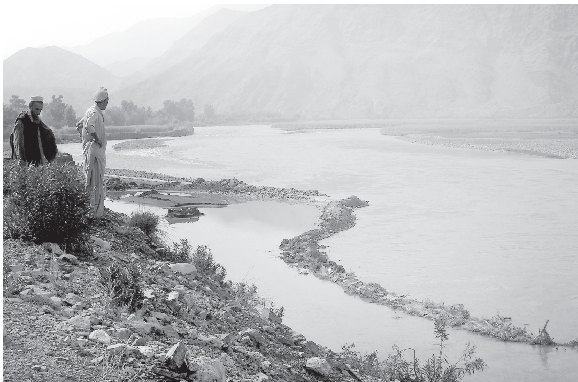
洪水で崩壊したコンクリート突堤のバルカシコト既存水路。突堤の先端が洗掘され水が取水口に流れなくなり、村民による堰上げの跡が見られる（2015年10月14日）
