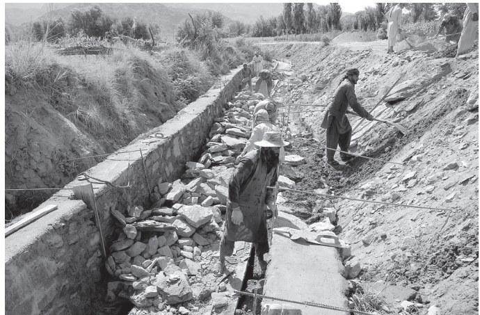
主幹排水路工事の現場監督はエンジニア ファヒーム (2016年8月30日)
