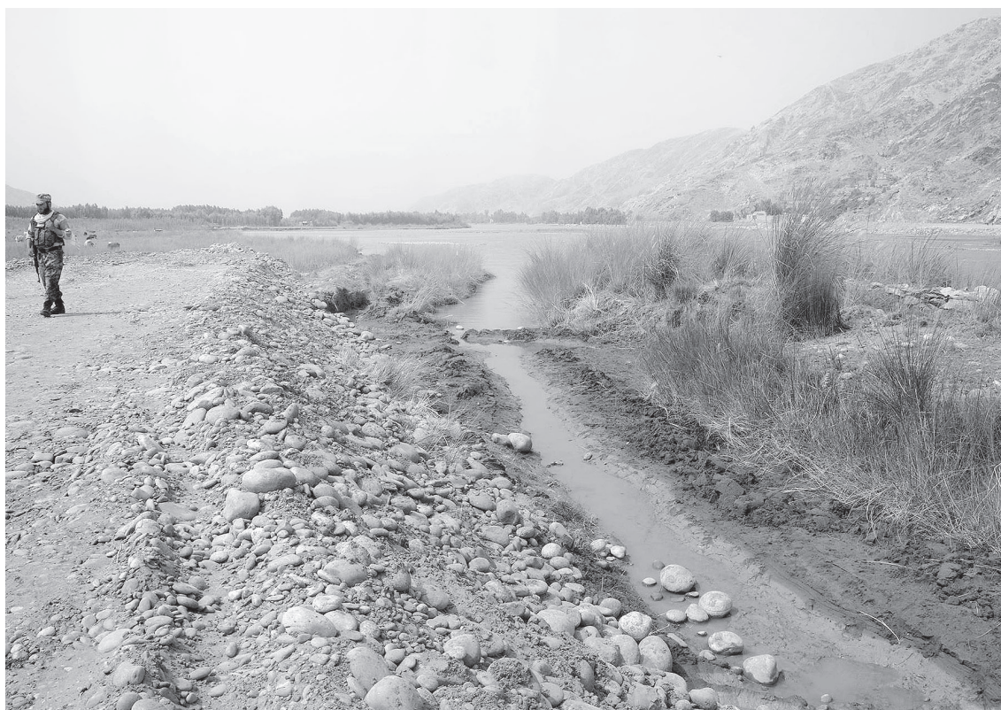
ミラーン堰上流対岸の旧取水路と消滅した農地。小規模ではあっても、このように、洪水流入後荒廃する農地が絶えなかった。しめきり堤2.4km地点（2016年7月）
