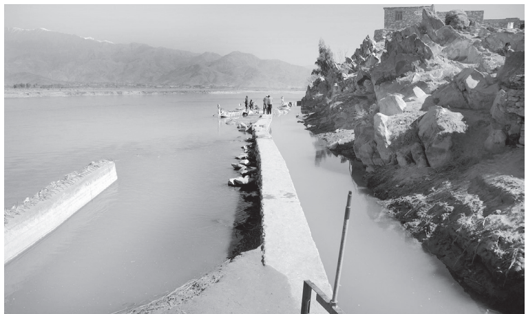
ここ数年の洪水で殆ど壊滅した既存の取水堰と取水口 ミラーン堰上流対岸 (2016年2月17日)
