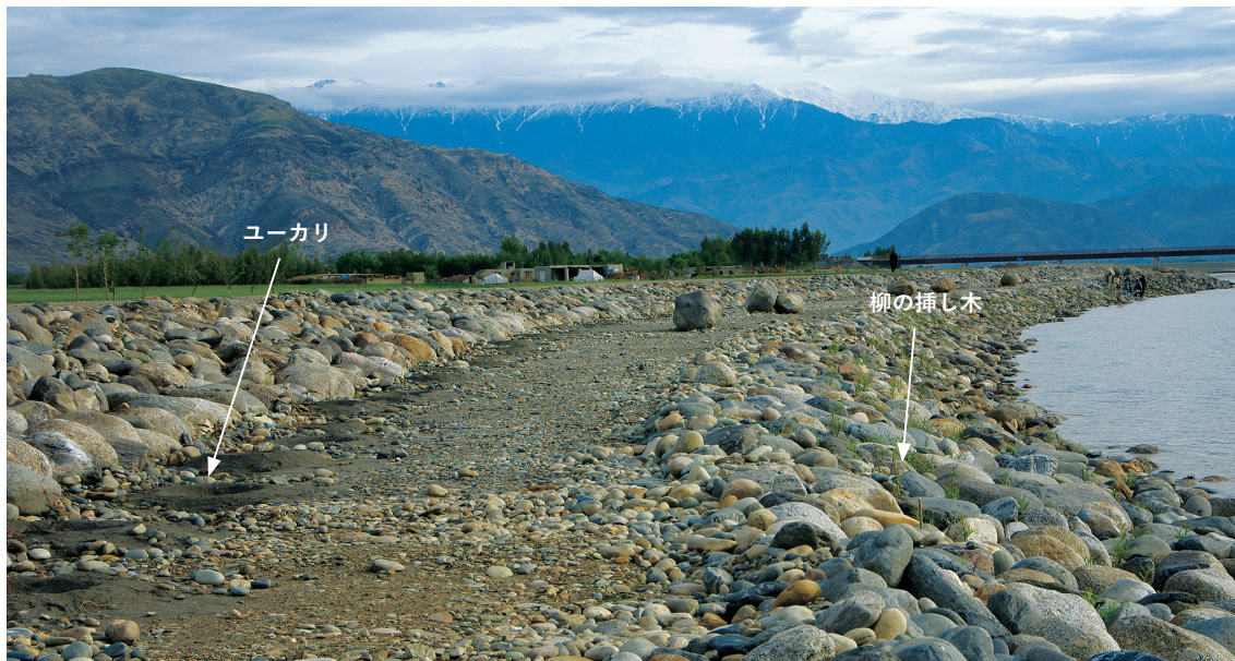
ベースド護岸堤に施された植生工。河側法面の巨礫間に柳枝工、堤2段目法尻 のりじり にはユーカリが植えられた。石の間に芽吹いた柳が見える（2011年4月16日）
