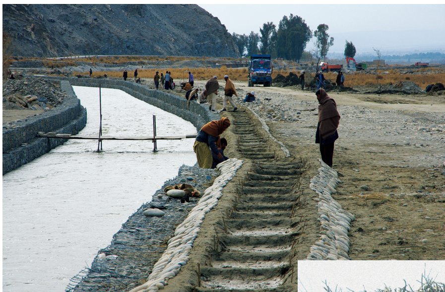
上：カマ第Ⅱ主幹水路。用水路両壁の蛇籠工背面に柳の枝を挿し木する（柳枝工）（2013年1月14日）
