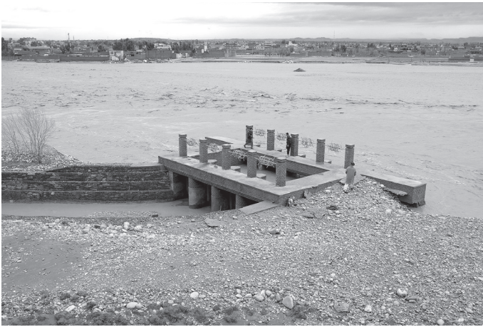
季節外れの大洪水。水門左側は護岸壁が洗掘され蛇籠壁のみが残ったが村への洪水流入は防がれた。ベスード第II取水門。2015年2月25日
