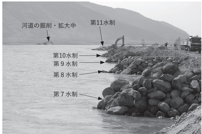
ミラーン村落保護。護岸600mまでは50m間隔で石出し水制(計12基)を置き、下流では高水敷に堤防を置き、越流型水制で保護する
