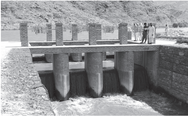
今年完成したカシコト取水門。PMSでは、①河道全面石張り式斜め堰、②二重堰板方式の取水門、③蛇籠工・柳枝工による主幹水路、④調節池 (沈砂池、堰板式の送水門、底水をさらうスライド式排水門)を一連の「取水システム」とし、将来クナル河流域やカプール河本川で拡大する方針
