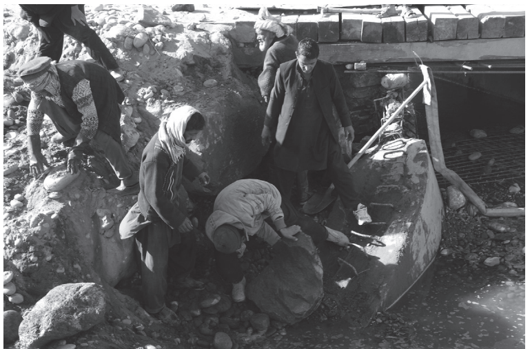
カシコート堰内河道④の改修工事。昨夏の大洪水による決壊部。河の中での作業は厳しい(2013年12月)
