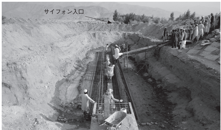
マルワリード用水路のガンバリ沙漠末端から送水される、シギ地区へのサイフォン造設中 (2012年10月22日)
