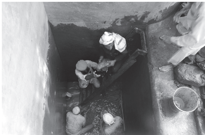
用水路14.4km地点のサイフォンの浚渫作業。このサイフォン建設に携わった作業員で用水路に対する愛着が強い
