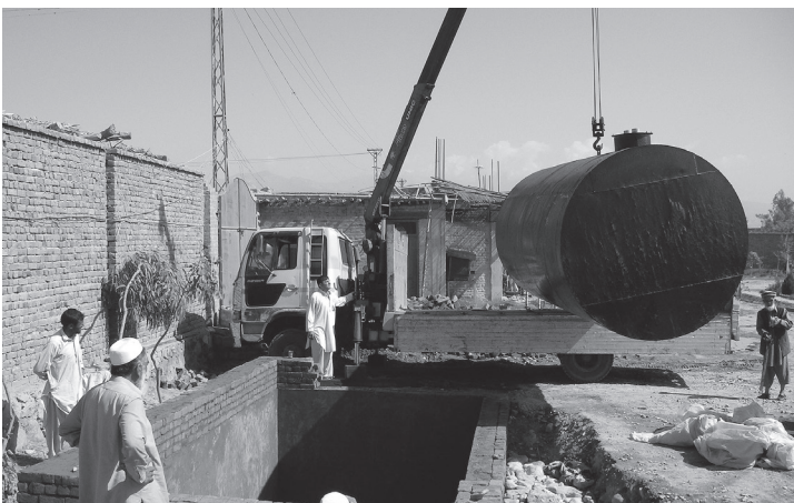
ジャララバード事務所に設置される給油タンク
