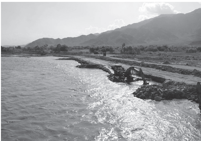
カシコート護岸。川幅を狭めていた旧堤防を撤去し、2段の新堤防を築造中。9基の水制を護岸壁に密着させる(2012年4月)
