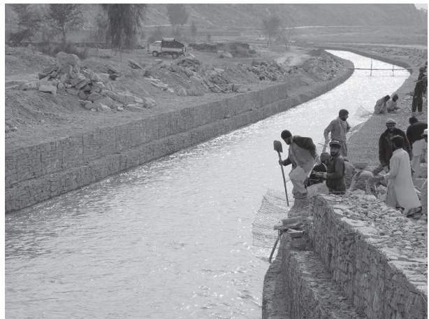
通水直後のカマ用水路、手前に新設した水門がある
