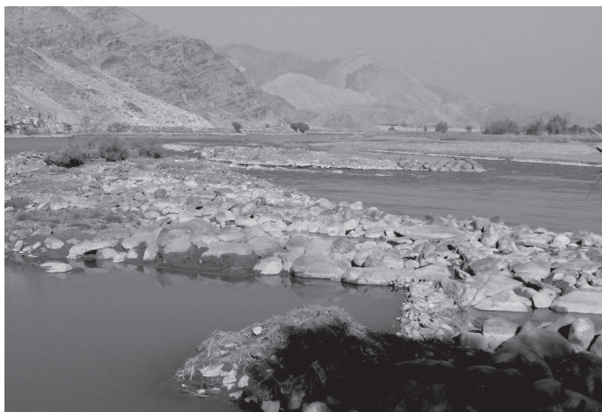
マルワリード取水堰。洪水により堰対岸の中州が流失した
