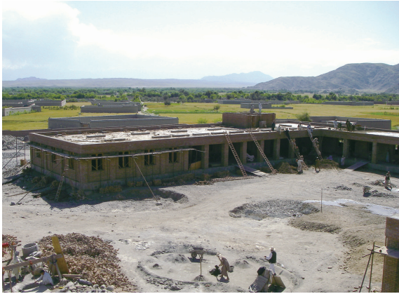
モスクに併設されるマドラサ（伝統的な寺子屋）も建設中
