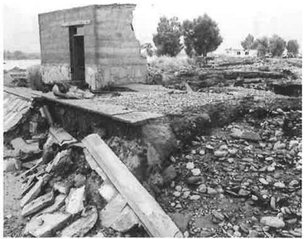
全壊に近い被害を受けた取水口のチョコキダール（守衛）小屋
