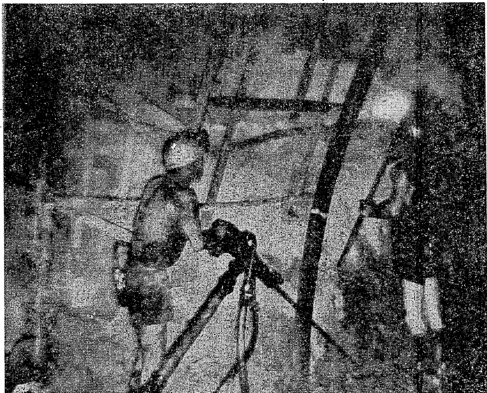
坑内の、掘進現場のきびしい労働。胸のなかにくすぶる怒りが、いつか再び燃えあがらずにはいまい。
