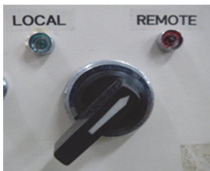
図 9 現場と遠隔の切り替えスイッチ
