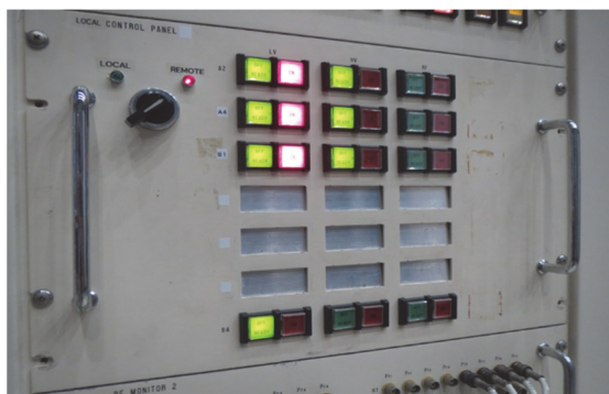
図 11 改造後の現場用昇降圧スイッチの外観
