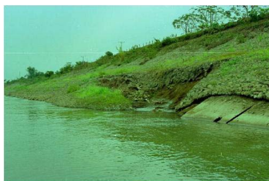
写真4-25 崩落し始めた蛇籠 (1998年2月)
