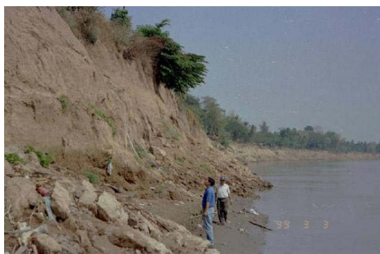
写真4-22 侵食進行中の河岸 (1999年3月)
