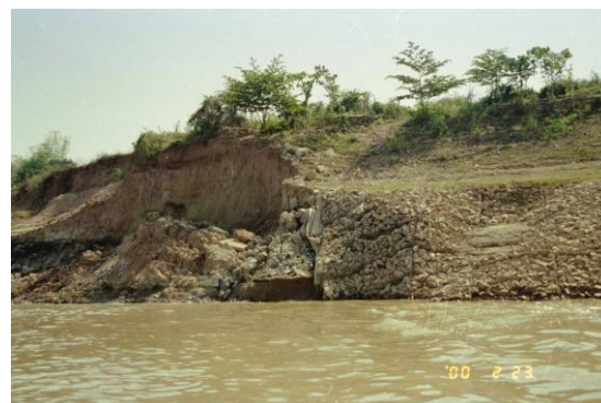
写真4-21 護岸上流側崩壊 (2000年2月)
