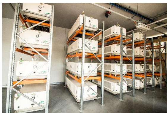
図 5.17 水素貯蔵システムの外観
