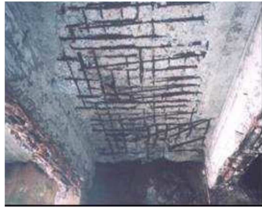
港湾コンクリート構造物の劣化
