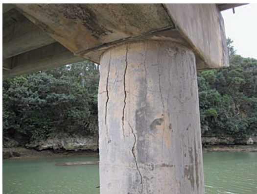
写真3 腐食ひび割れの発生した橋脚
