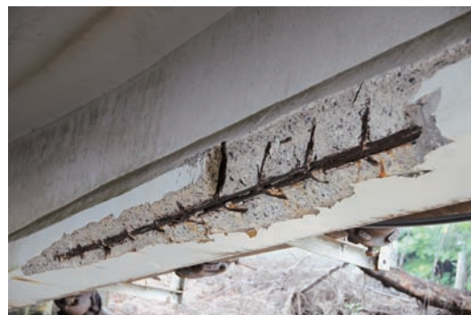
写真4 かぶりコンクリートのはく落
