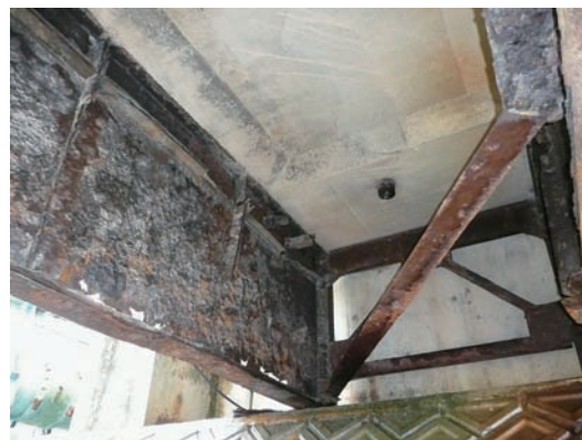
写真2 桁内側の腐食状況
