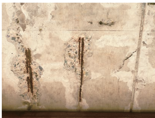
写真6 中性化による鋼材腐食
