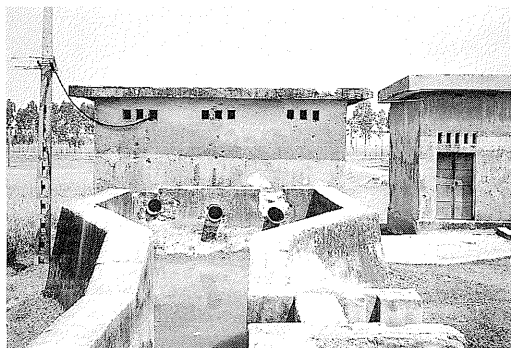
写真6 写真5の中規模揚水機場の反対側 (Bac Ninh 県). 灌溉と排水共用で、写真5と合わせて、灌溉は電力揚水、排水は重力排水と推測される。
