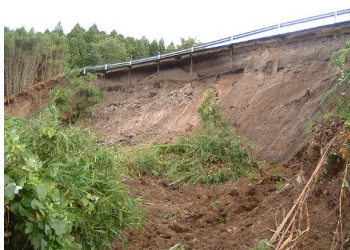
(2) 異常降雨による被災状況
