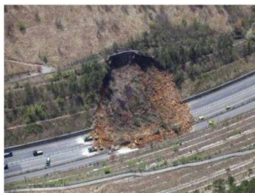
(4) 熊本地震による切土の被災状況
