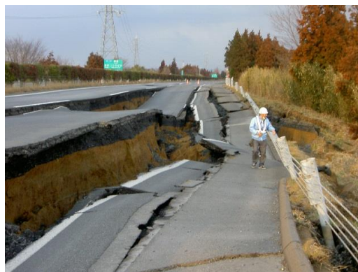
(2) 東北地方太平洋沖地震による被災状況
