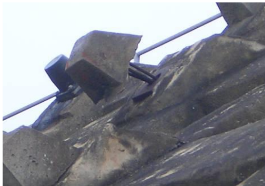
(1) アンカーの破断
