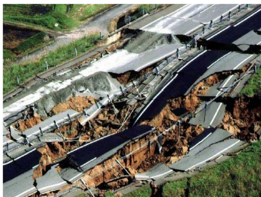
(1) 新潟県中越地震による被災状況
