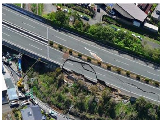
(3) 熊本地震による被災状況
